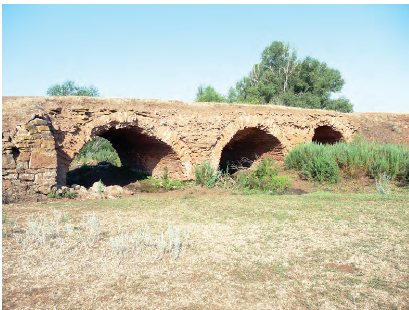
Трехарочный кирпичный мост через овраг Каменный к северу от с. Татищево Переволоцкого района Оренбургской области. XVIII в. Дорога из крепости Оренбург в крепость Переволоцк. Фото автора. 2013 г.
