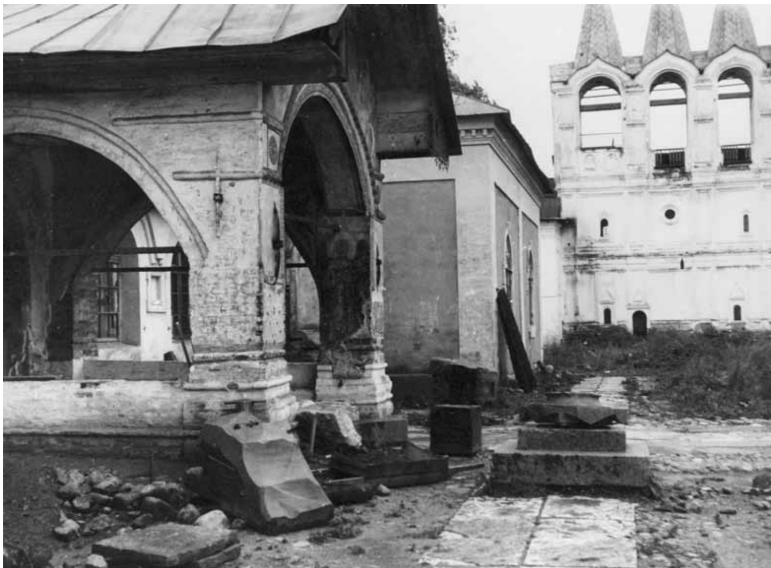
Полуразрушенный портал западного фасада Успенского собора. 14 сентября 1988 г.
