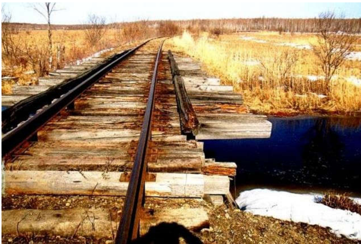
Фото 16. Зброшеный участок Оборской дороги
