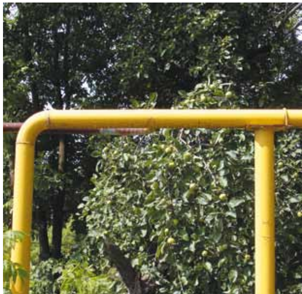
■ Газопровод в п. Окский
