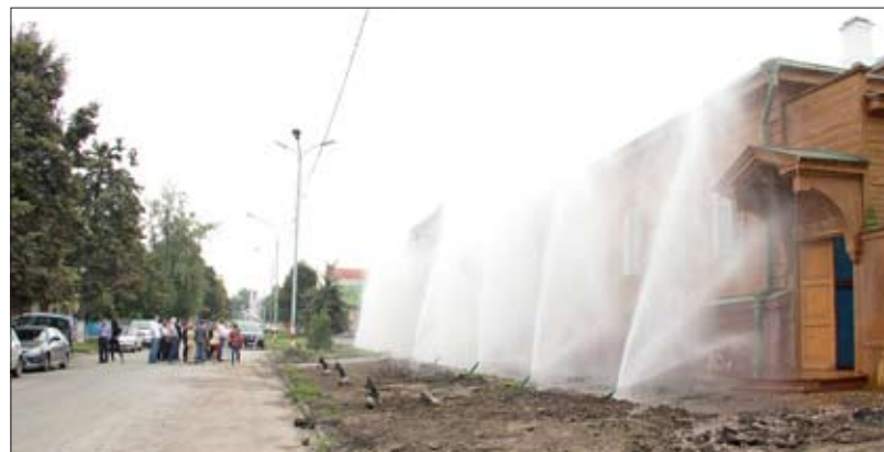
Система автоматического водяного пожаротушения в действии
