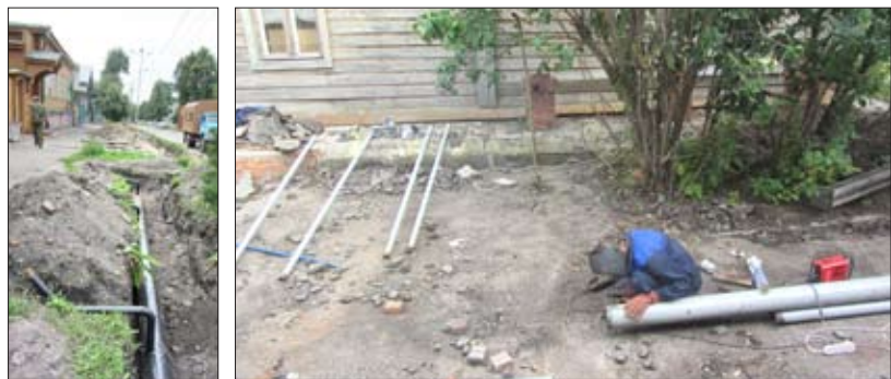
Реконструкция дренчерной системы
