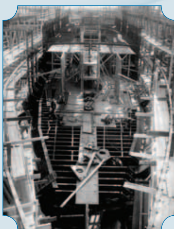
Подetailная сборка корпуса на стапеле – одна из наиболее трудоёмких операций в судостроении в конце 1930-х гг.
