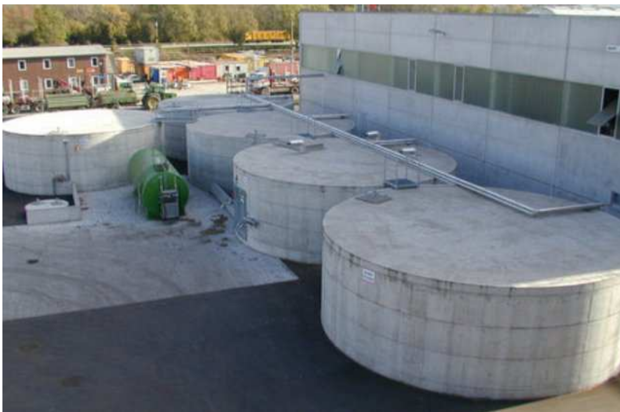
Рис. 38. Пожарные резервуары из железобетона [28]
