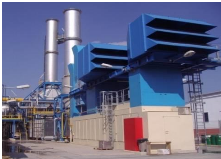
Ilustración 5-24: Instalación de cogeneración La Azucarera, Guadalete.
