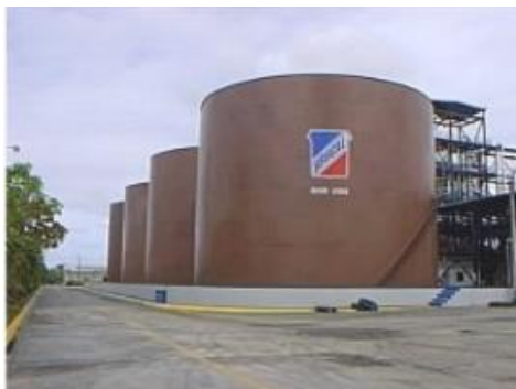
Ilustración 5-7: Almacenamiento de melaza
