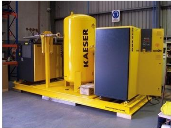
Ilustración 5-13: Estación de aire comprimido [21]
