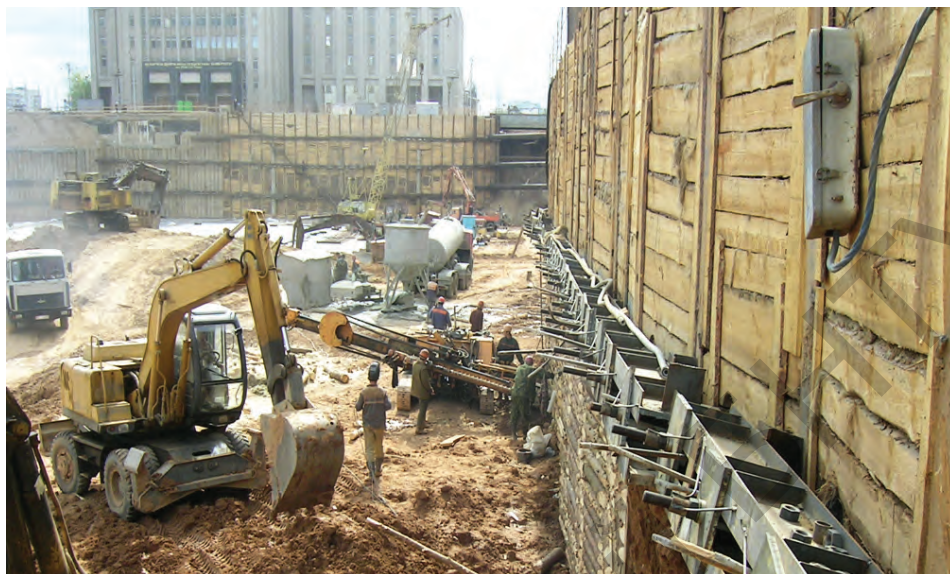
Крепление котлована системой буроинъекционных анкеров. Внедрение НИР кафедры ГиЭС при реконструкции пл. Независимости, 2004 г.
