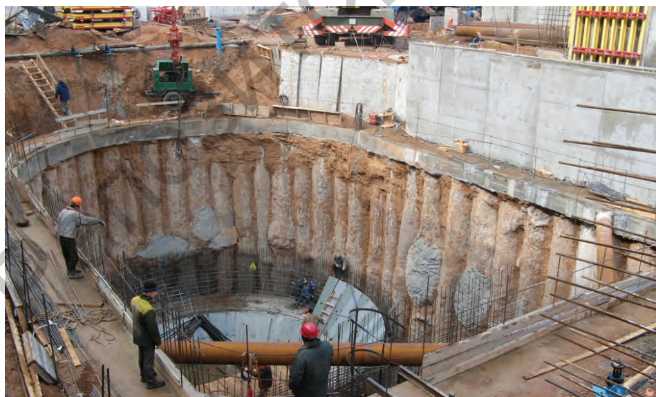
Реконструкция Белорусского металлургического завода. Крепление котлована буронабивными сваями диаметром 100 см. Внедрение НИР кафедры ГиЭС
