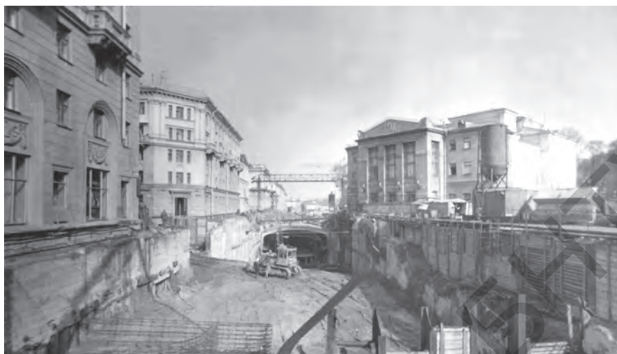
Котлован на стадии строительства станции метро «Купаловская». Здесь в значительных объемах использовались методы крепления котлована бура-инъекционными системами, разработанными кафедрой основание и фундаменты, руководитель М.И. Никитенко
