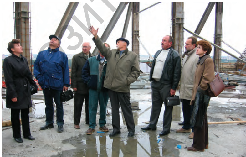
Консультация в прямом смысле «на высоте». Научный руководитель проекта и строительства Национальной библиотеки Республики Беларусь д.т.н., профессор Т.М. Пецольд с группой сотрудников проводит консультацию по возникшим проблемам на отметке +50 м над уровнем земли
