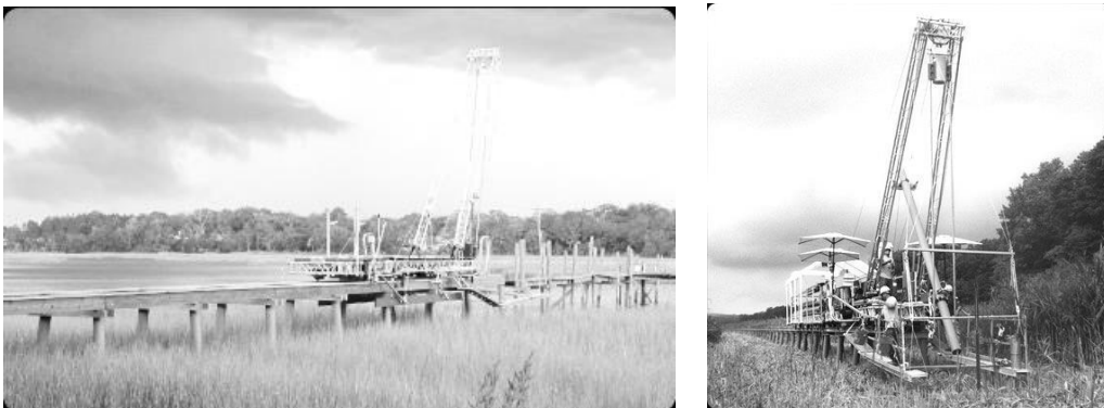
Рис. 15. Доставка будівельного обладнання та будівельників при «естакадній» системі будівництва відбувається за допомогою спеціального конвеєра
