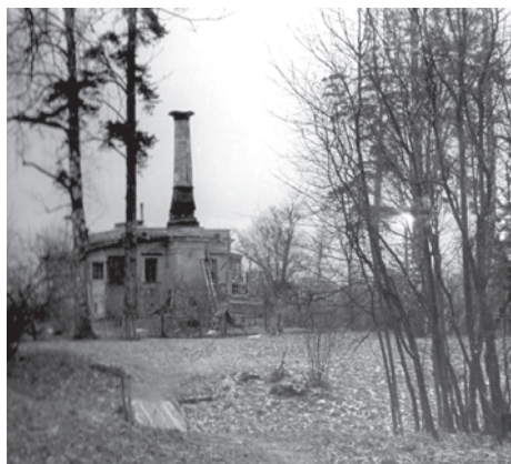
Илл. 11. Поврежденное здание водокачки на берегу Финского залива. Начало 1980-х гг.
