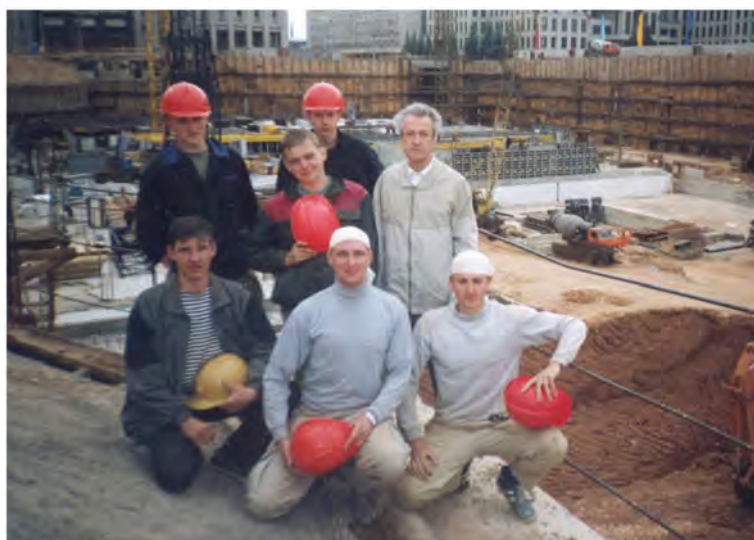
Студенты специальности ПГС во время производственной практики на реконструкции пл. Независимости. 2005 г.
