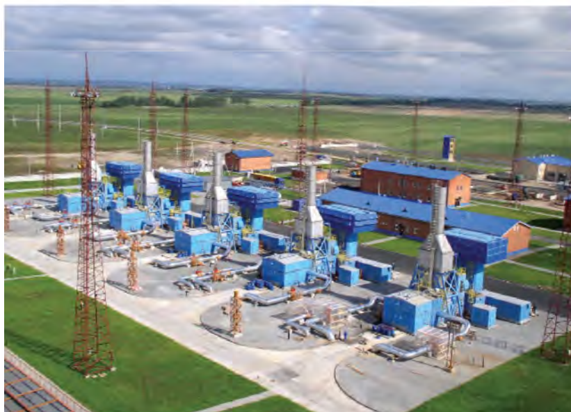
Компрессорную станцию на трассе газопровода «Ямал-Европа» ОАО «Минскпромстрой» возвело со значительным сокращением сроков
