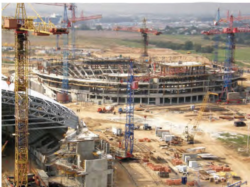
Панорама строительства комплекса «Минск-Арена» на начальной стадии работ. Генеральный подрядчик ОАО «Минскпромстрой», ГПО «Минкстрой»
