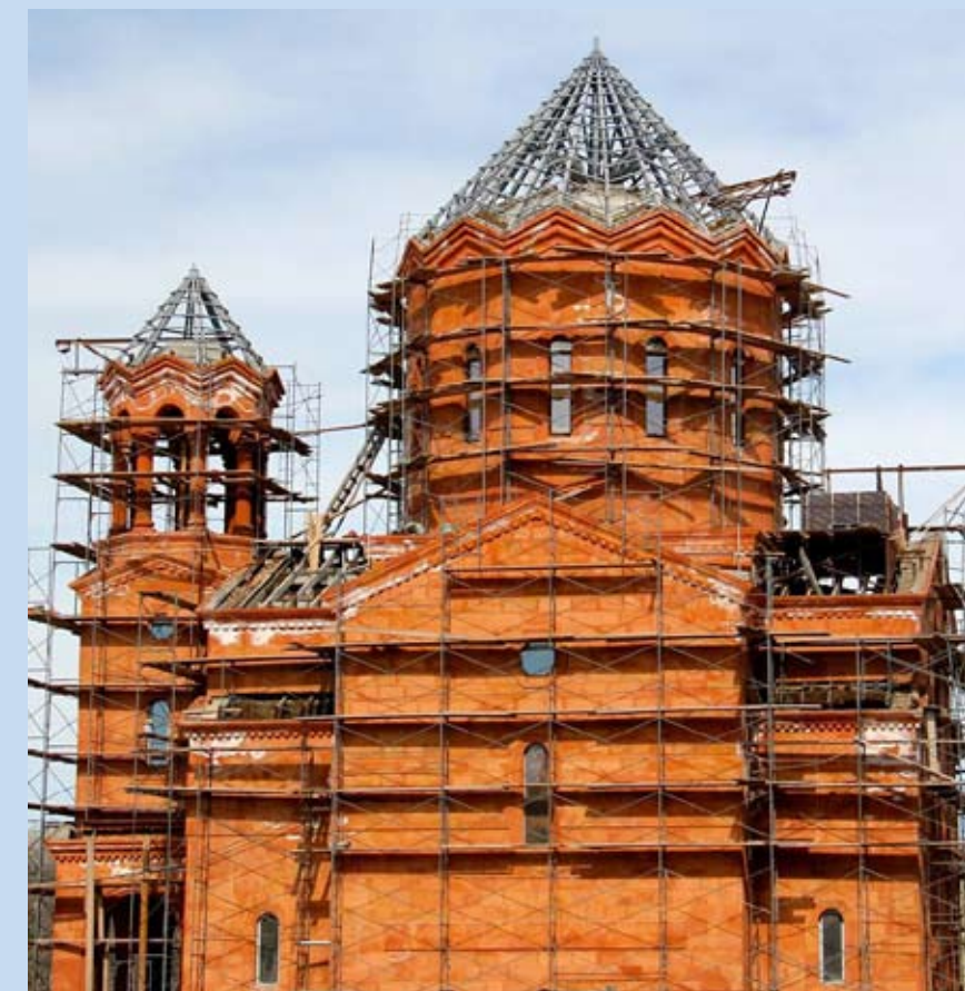
Строительство храма Сурб Григор Лусаворич Армянской Апостольской Церкви в Перми, на улице Чкалова
