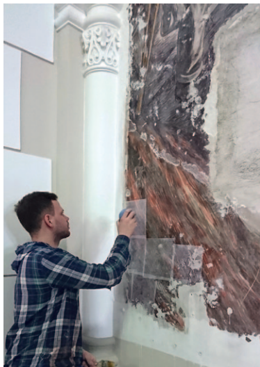
Ил. 5. Процесс укрепления штукатурного слоя методом инъектирования. Исполнитель — художник-реставратор А. Ф. Ковтун
