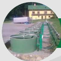
KRUHOVÉ ODCHOVNÉ NÁDRŽE
