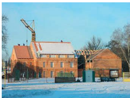
Budova Mezinárodního environmentálního vzdělávacího, poradenského a informačního střediska ochrany vod Vodňany (MEVPIS) před a během rekonstrukce.
