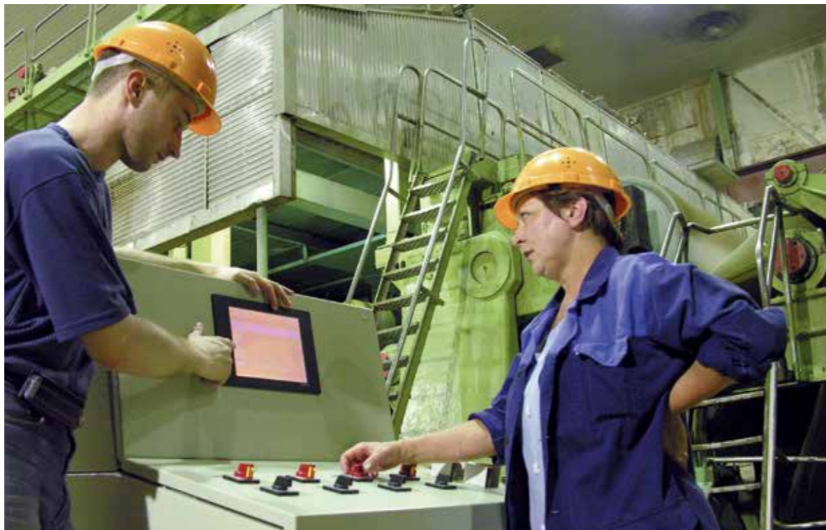
В период останова-2005 на сушильной машине №2 внедрена цифровая система управления электродвигателями на базе оборудования фирмы Mitsubishi
