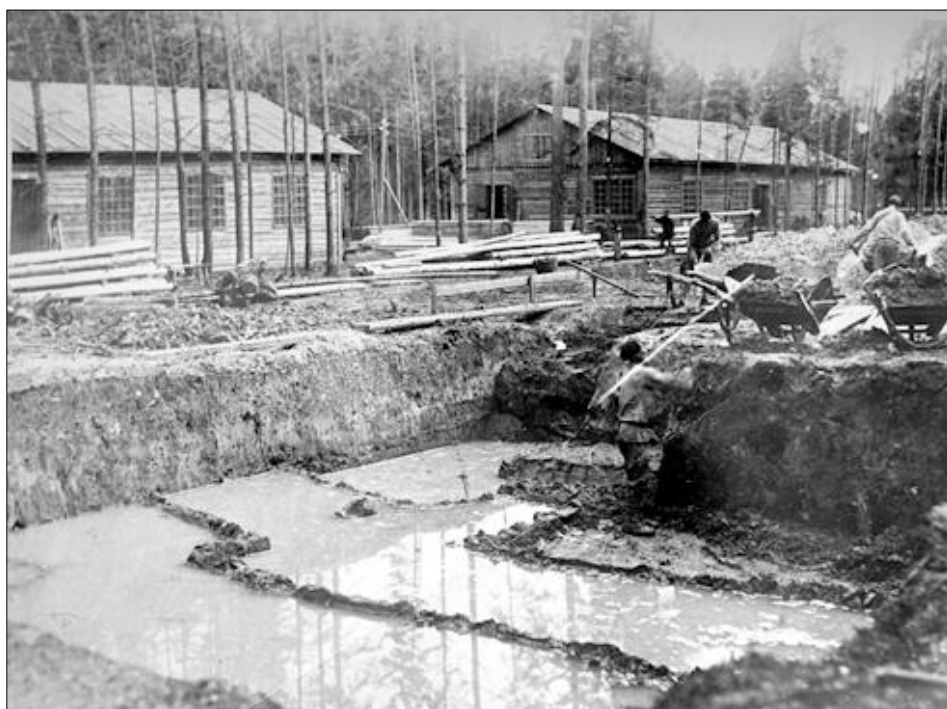
1919. Начало строительства Временной электростанции. От траншеи грунт отвозился в сторону тачками по деревянным настилам.
