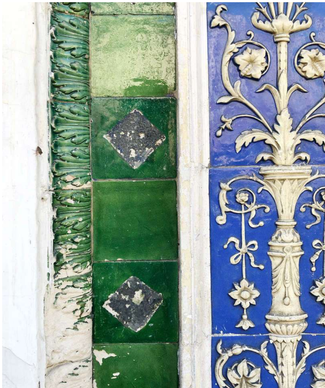
Ил. 3. Фрагмент керамического портала Московского Архитектурного Института. Современное состояние. Утраты исторических геральдических лилий. Фото автора, 2018 г.
