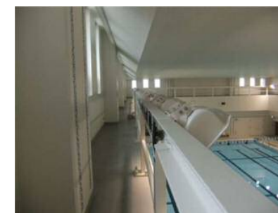
【プール 2 階メンテナンス通路】
