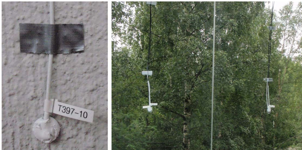
Kuva 4.6. Valmiit pintalämpötila-anturit kiinnitettynä ulkoseinään ja parvekelaseihin.
