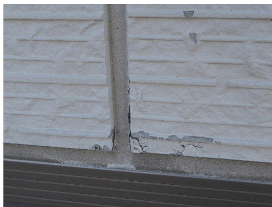
(b) 外装材の凍害（外気側）
