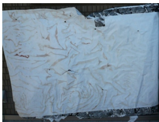
(b) 透湿防水シート表面(合板側)
