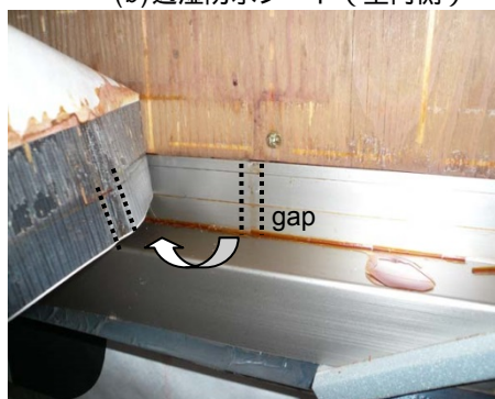
(d) 防水テープの隙間から灰汁が流出
