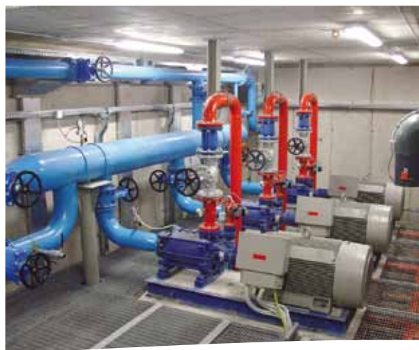
Middels stor pumpestasjon for snøanlegg.
